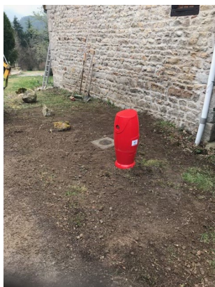
Poteau incendie à Roddier
